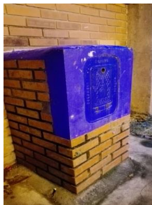
Foto 17. Punto de verificación de la calidad de agua potable
