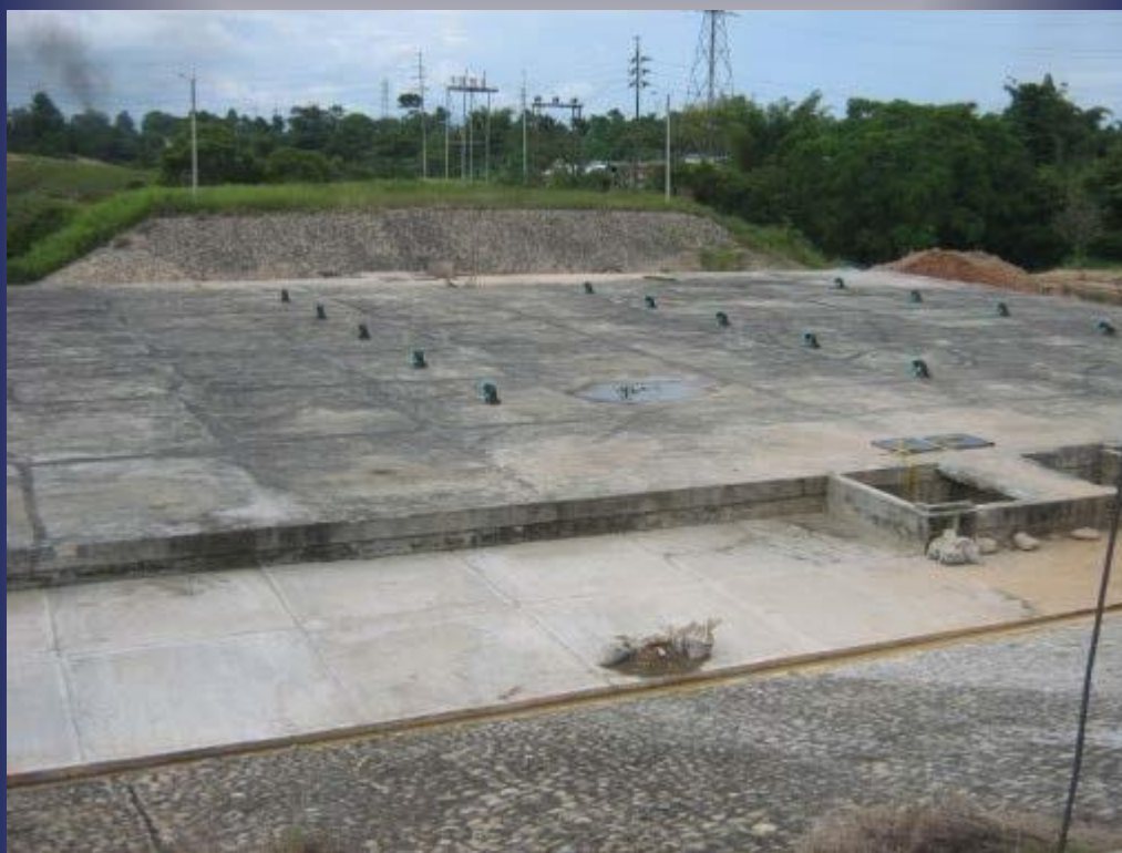
Foto No 4. Tanques de Almacenamiento Semienterrado de Agua Tratada
