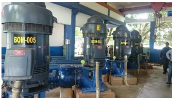
Foto 8. Conjunto de Bombas – Motor
