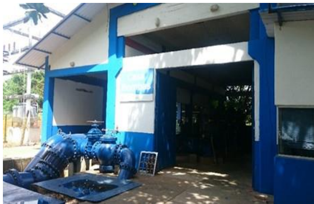
Foto 6. Captación o Bocatoma
