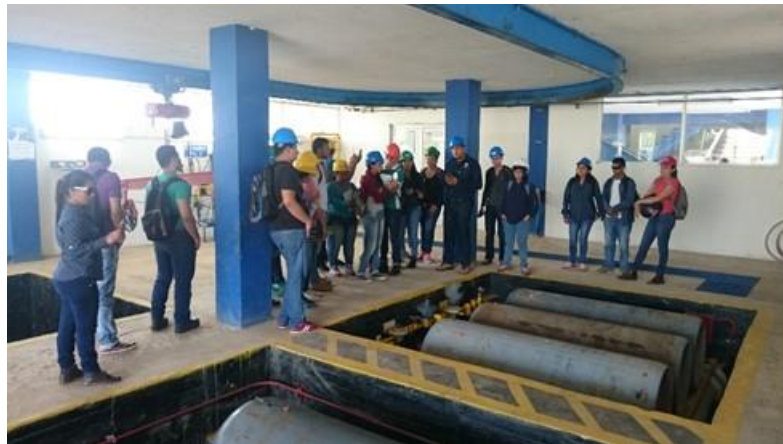
Foto 15. Zona de Contenedores de Cloro
