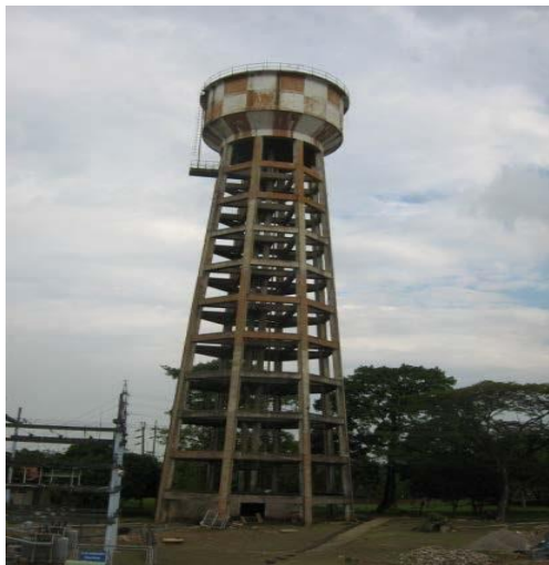
Foto 16. Tanques de almacenamiento elevado
